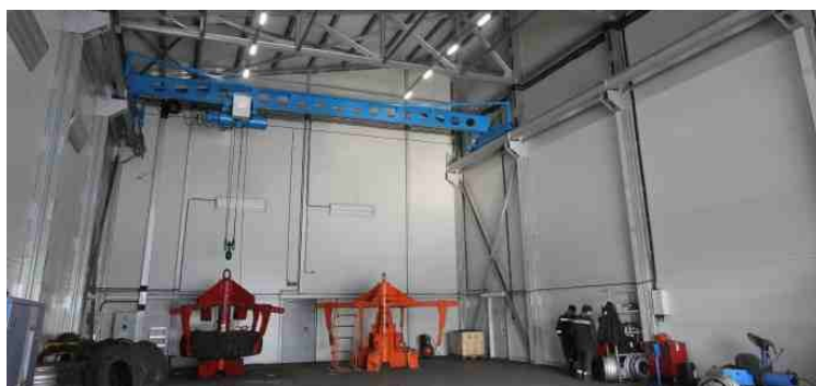
Шиномонтажный цех с краном
